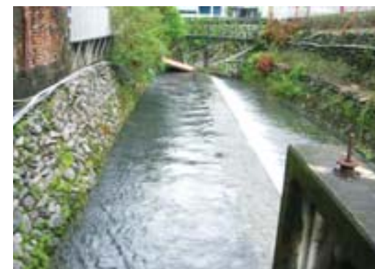
▲經地下堰堤集水廊道引水路出隧道後，流經梯形水圳及側向溢流堰，水質清澈，也供應沿線民生用水。
