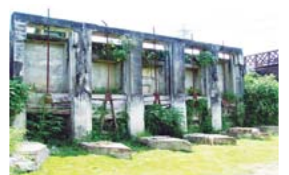
▲道光 17 年 (1837) 鳳山知縣曹謹倡建曹公圳的「曹公舊圳」五孔涵水門，至今猶在。（圖片提供／鄭溫乾）
