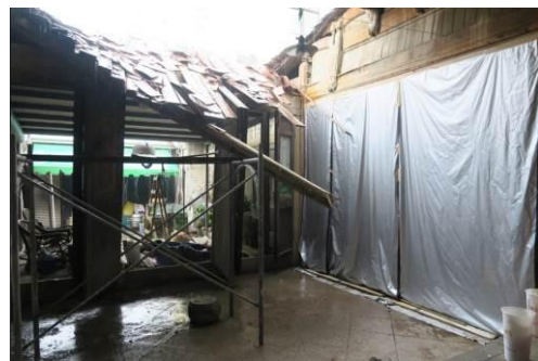
5 月 11 日文化資產局配合工班前來處理，此時台南正下著豪雨
