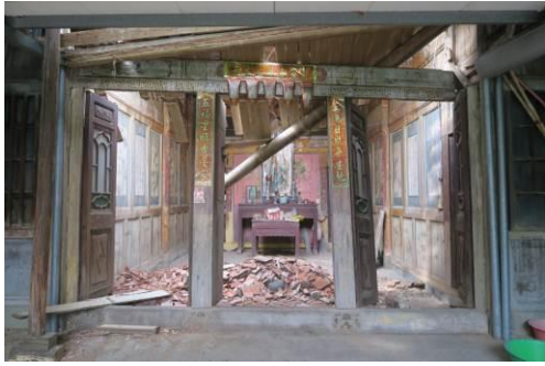
4 月初正廳前坡屋頂塌陷格扇門框傾斜
