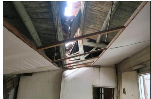
5月23日右伸手前廳屋頂塌陷
